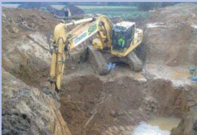
Poste de refoulement Poulajous
