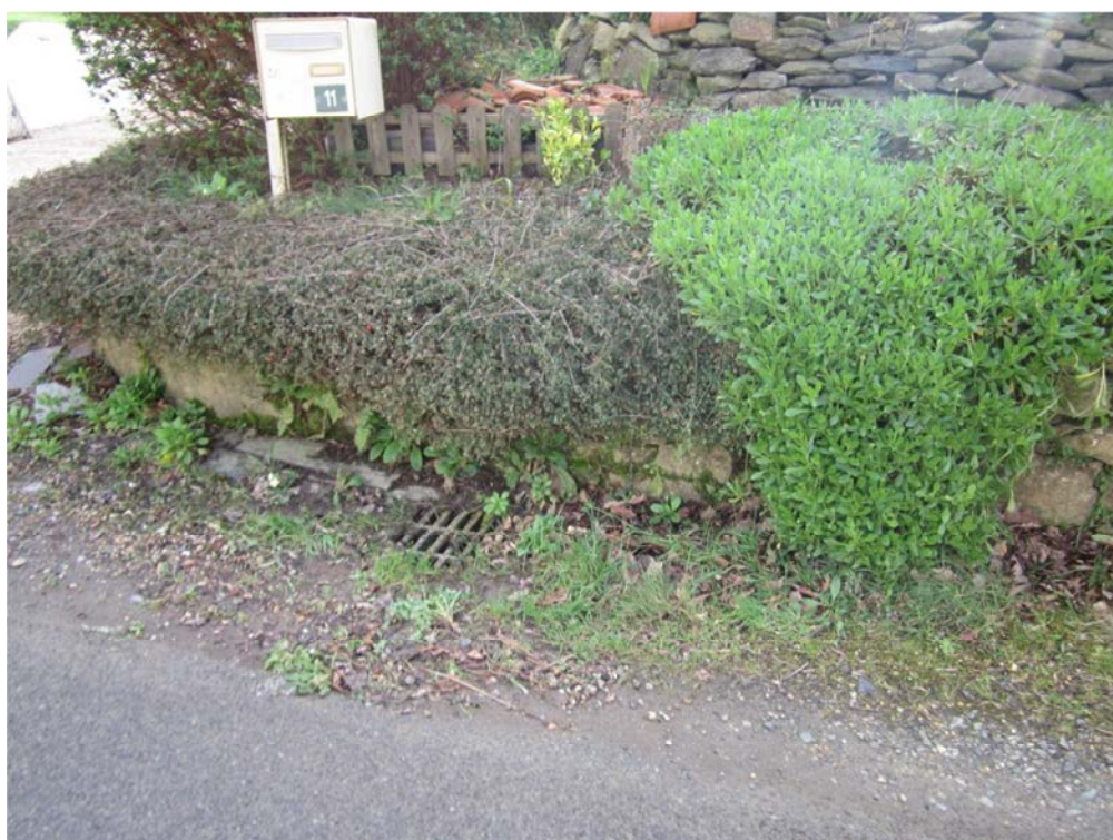
photo n°2. Réseau EP route de Croajou
